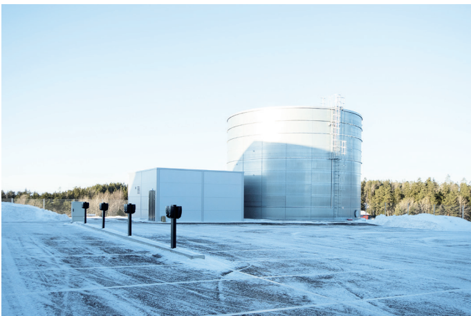
Brannsikkerheten i bygget opprettholdes blant annet av denne 1,6 millioner liter store sprinklertanken.
